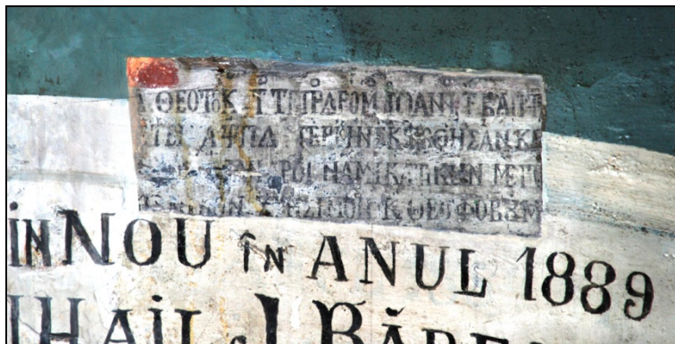
Fig. 3. Pisania din pronaos - peretele vestic - repictată în 1889. Se observă sub stratul nou pictura originală, realizată în frescă în 1786
